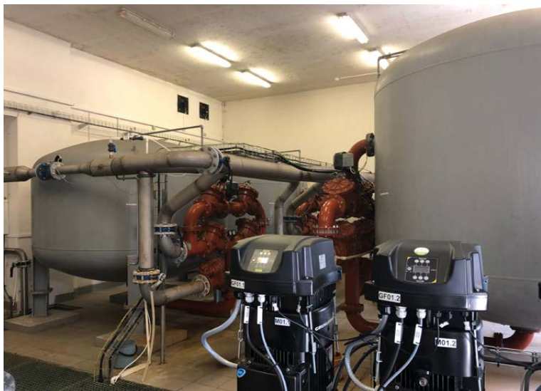
Úpravna pitné vody | Foto: redakce
