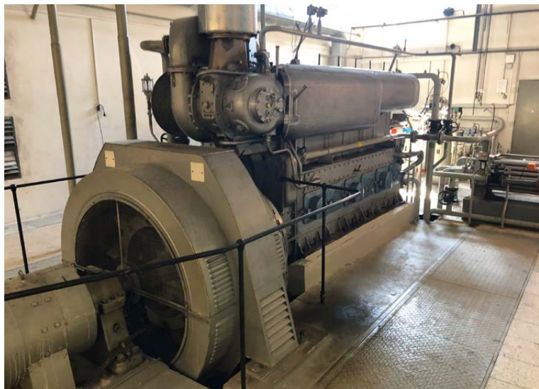
Náhradní zdroj elektrické energie | Foto: redakce
