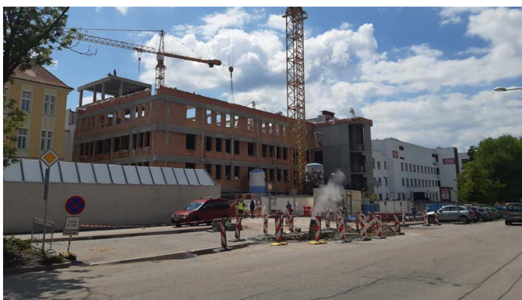
Průběh výstavby objektu SO 08 – pavilon CH1. Pohled na prefabrikovanou konstrukci a výplňové zdivo. Dílo bylo realizováno při zachování chodu magnetické rezonance, což si vyžádalo nutné provozní opatření respektující minimalizaci vibrací z hlediska MR přístrojů a zajištění celistvosti stávající hydroizolace na úrovni stropu 1. NP
